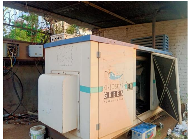
h) DG Set: 2.5KW (1 Nos.)
